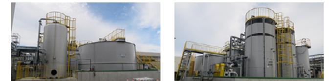
(株)ヤマハミュージックマニュファクチャリング本社工場の廃水処理設備
