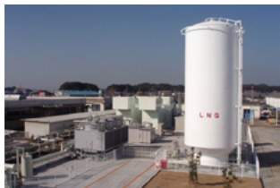
掛川工場のコージェネレーション設備
