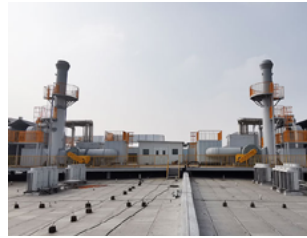
杭州ヤマハのVOC処理施設
