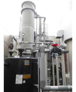
本社事業所の地下水浄化装置
