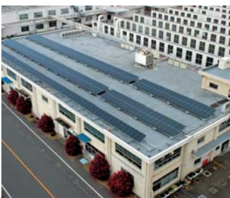
太陽光発電システム
