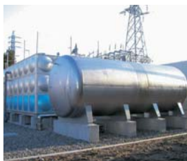
井水タンク(ヤマハ(株)豊岡工場)
