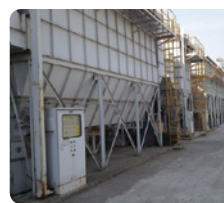
▲集塵設備（杭州ヤマハ）
