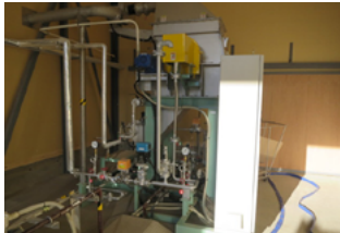
CD dryer (Kitami Mokuzai)
