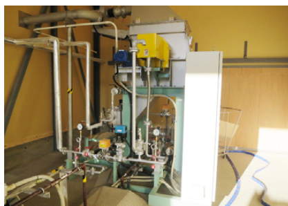
CD dryer (Kitami Mokuzai Co., Ltd.)
