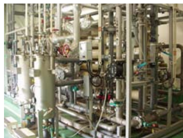
逆浸透膜（RO膜）装置（豊岡工場）
