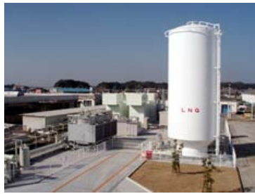
LNGサテライト設備
