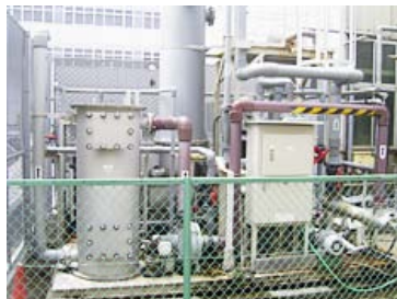
本社工場の地下水浄化装置
