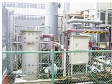
本社工場の地下水浄化装置
