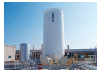
LNGサテライト施設
