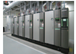
天然ガス焚きボイラー
